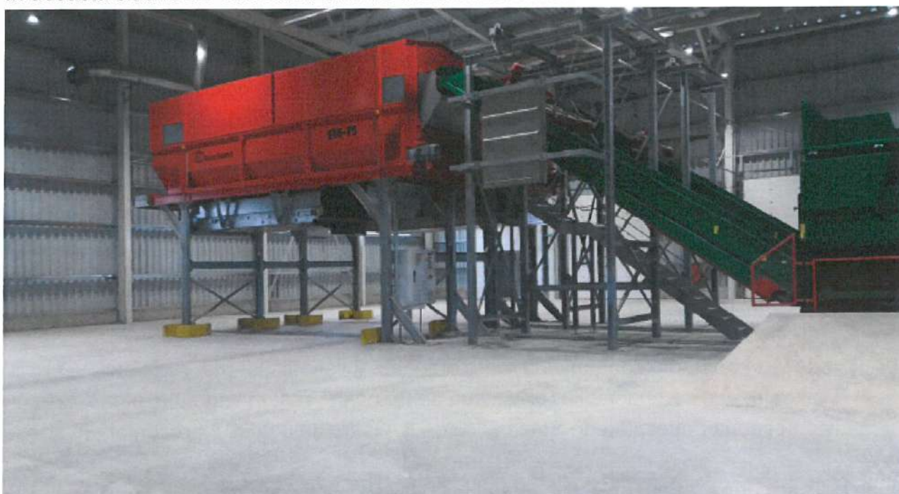
Tratarea mecanica a deseurilor in instalatia de TMB
