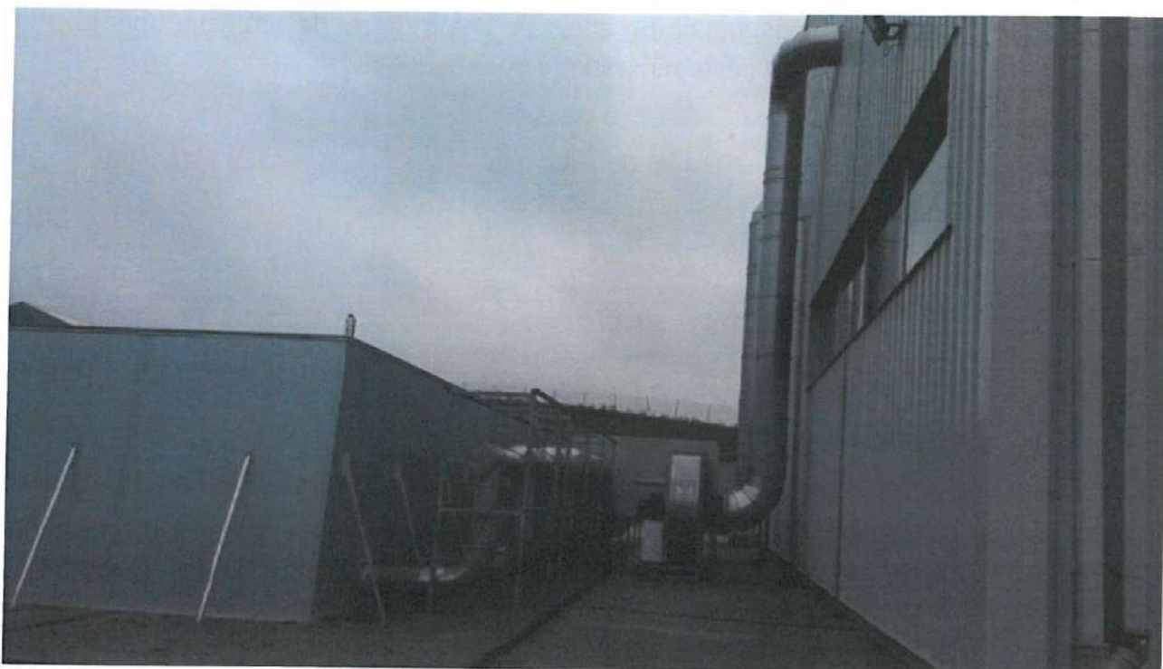
Biofiltru aferent instalatiei TMB
